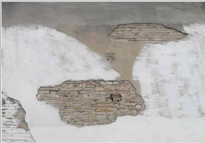
FOTO 30. Esempi di distacco di intonaci esterni da ristrutturare
