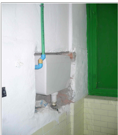
FOTO 25. Particolare dell'attacco alla cassetta del servizio igienico
