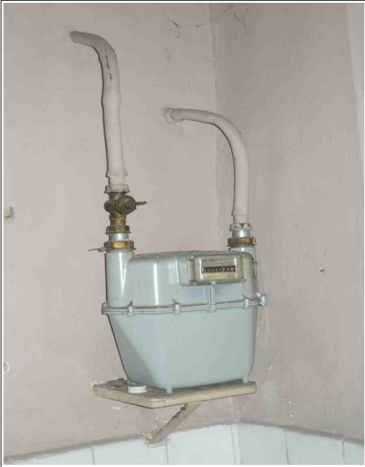
FOTO 29. Contatore del gas esistente e non utilizzato
