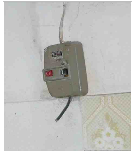
FOTO 19, 20, 21, 22 e 23. Particolari dell'impianto elettrico esistente non corretto per il funzionamento in sicurezza
