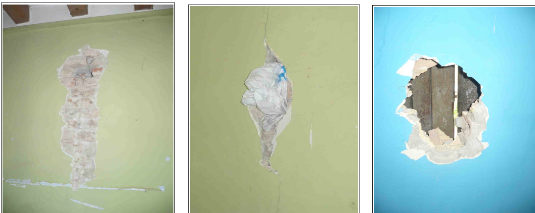
FOTO 33, 34 e 35. Brecce da richiudere in muratura presenti al secondo piano
