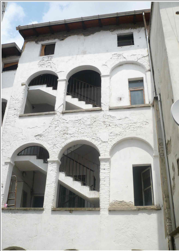
FOTO 2. Secondo corpo dell'edificio con elementi di distacco dell'intonaco
