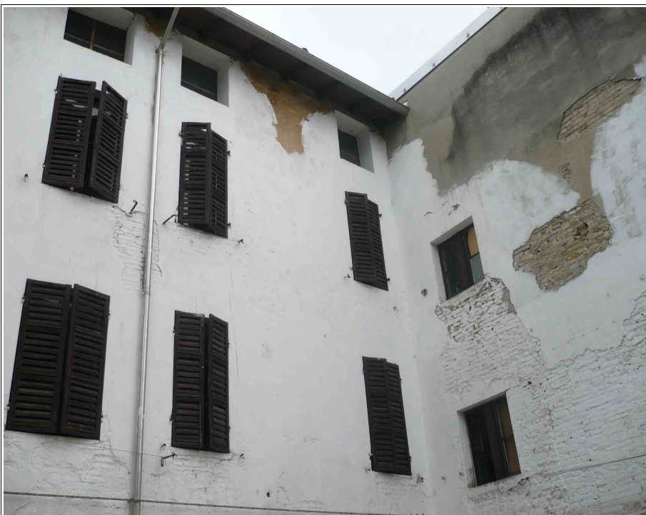
FOTO 1. Primo corpo dell'edificio con elementi di distacco dell'intonaco
