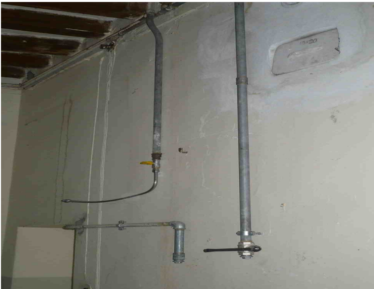
FOTO 26, 27 e 28. Particolari dell'impianto idraulico esistente
